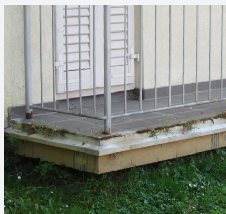
Slika 18: Nepravilna izvedba odvodnje sa nagibom i okapnicom
