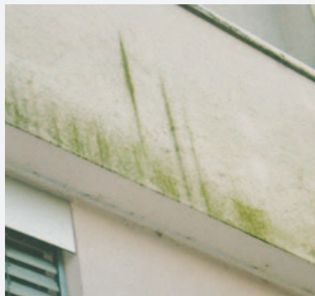
Slika 16: Nepravilna izvedba istaka sa okapom i limenim opšavom sa gornje strane
